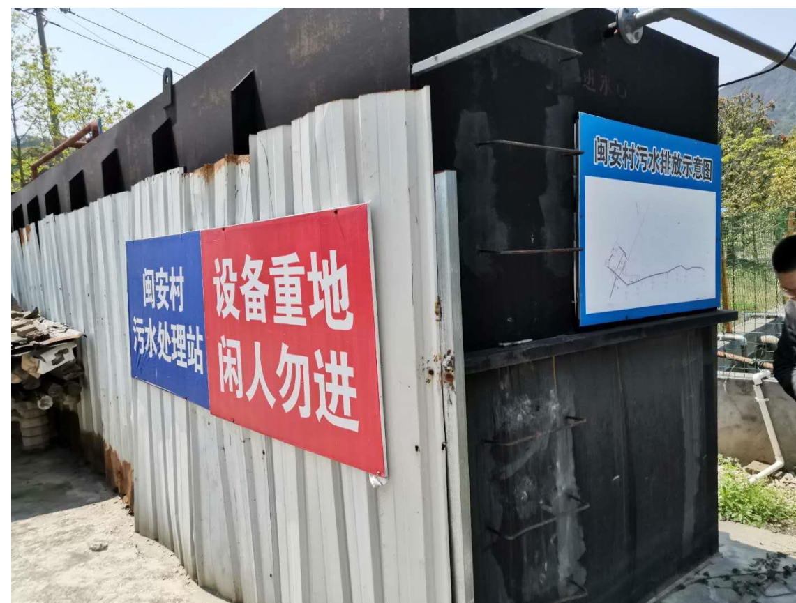
图4.1-13 闽安村污水处理设施现状
