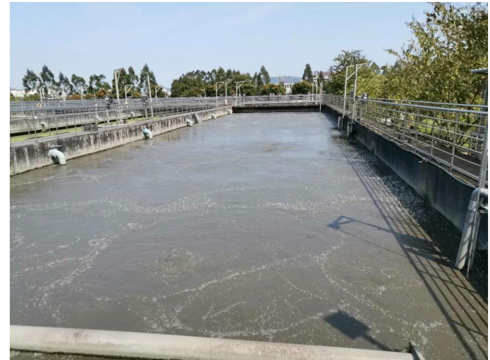
图4.1-7 长安污水处理厂现场情况
