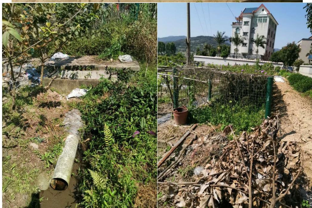
图4.1-12 鳌溪村污水处理设施现状
